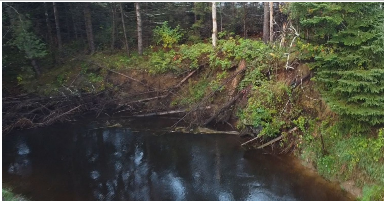
Photo 2. Zone d'érosion observée à l'automne 2024 (1+530).
