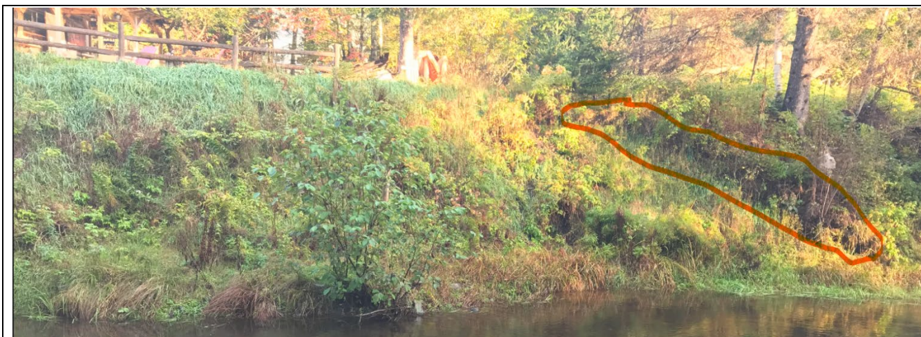
Photo 5. Cicatrice d'érosion identifiée à l'amont de la propriété de [REDACTED] (1+560).
