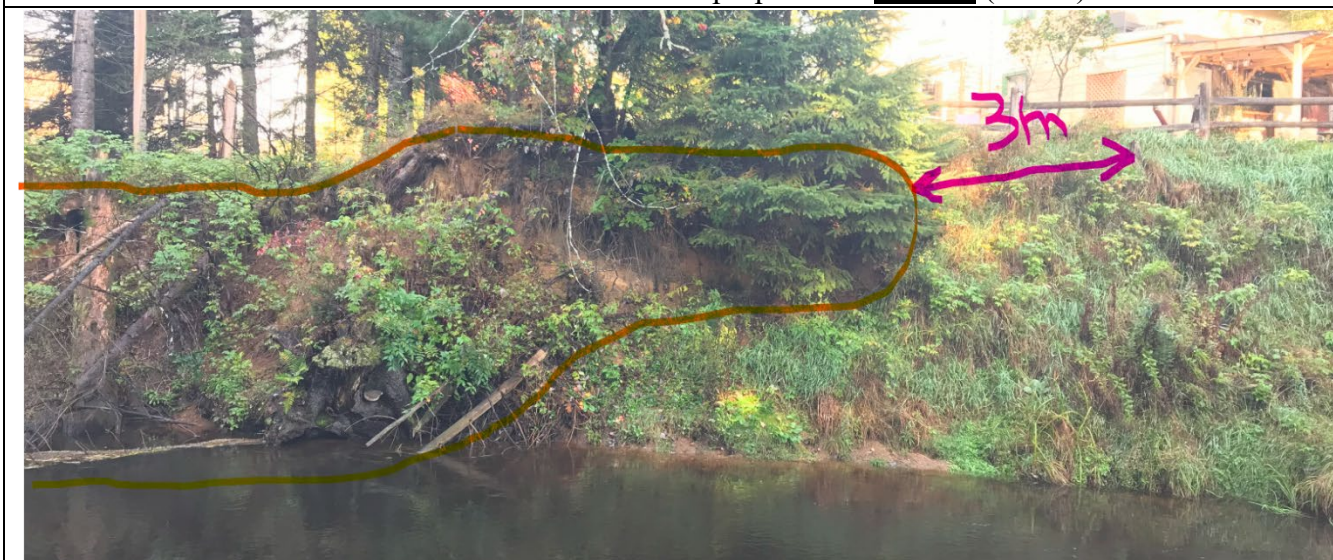
Photo 6. Limite amont de la berge en érosion située à 3 m de distance d'un piquet (1+545).
